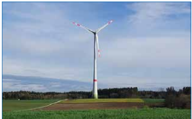
Bürger-Windrad Kammerberg der BEG-FS Bildnachweis: Bürger Energie Genossenschaft – Freisinger Land eG
